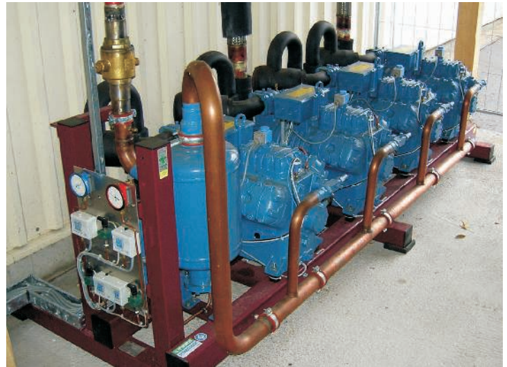
Abbildung 4: Größere Kälteanlagen werden mit mehreren Verdichtern ausgerüstet
