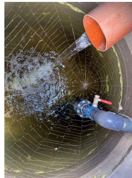
Abb. 10: Recyclingschacht mit Drainwasserzulauf und Tauchpumpe
