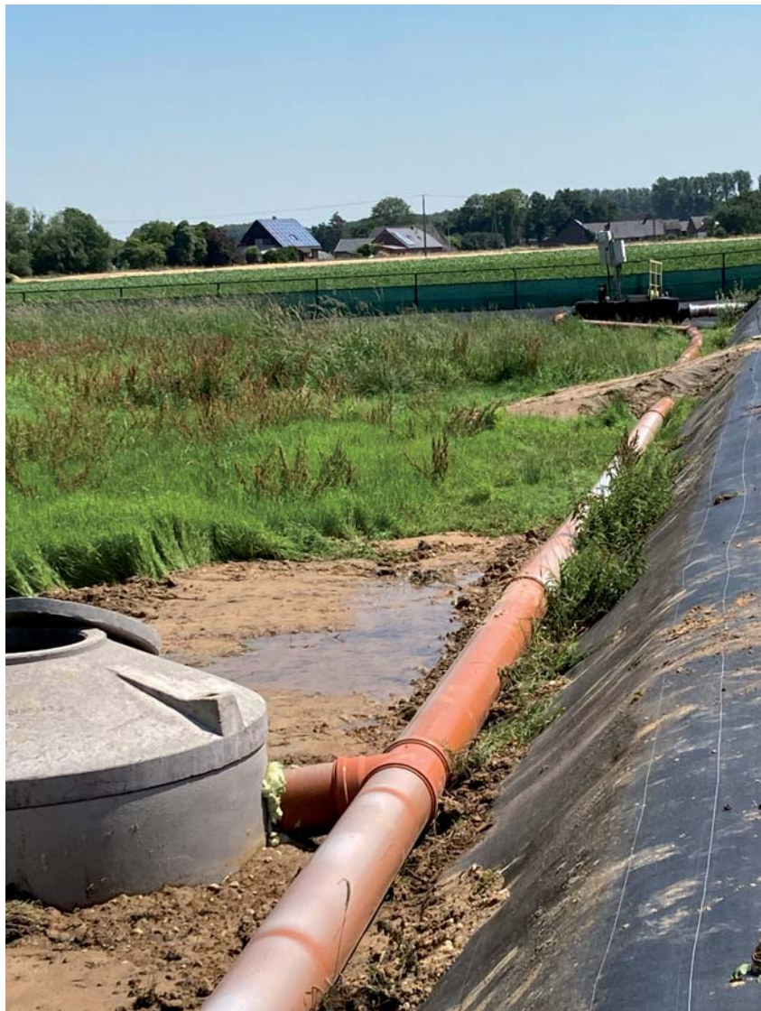
Abb. 9: Drainwasser-Leitung mit Messstation im Hintergrund und Recyclingschacht vorne links
