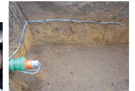
Sickerwasserführende und luftführende Schläuche verbinden eingebaute Saugplatten mit Sammelstation
