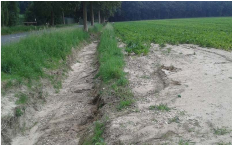
Abb. 40: Straßengraben (kurz vor den Erosionsereignissen ausgebaggert) unterhalb des Waldes an der Labbecker Straße am westlichen Rand des Einzugsgebietes der Gochfortsley
