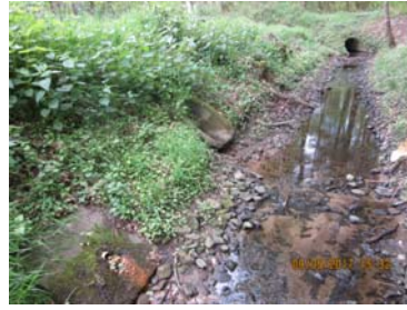
Abb. 98: Drainage mit Verockerung an einem Graben unmittelbar vor der Mündung in den Thesingbach
