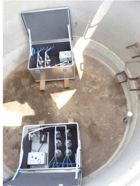
Abb. 171: Sammelstelle mit 2 Koffern für die Sickerwassersammlung
