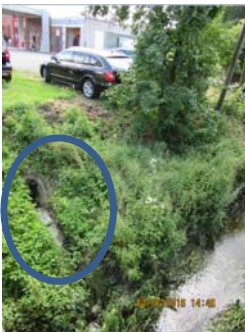
Abb. 109: Einleitung an der Tankstelle direkt neben dem Flaggenbach
