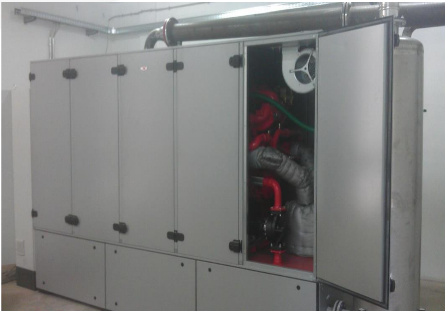
Anlage in REGELLO/ Italien
