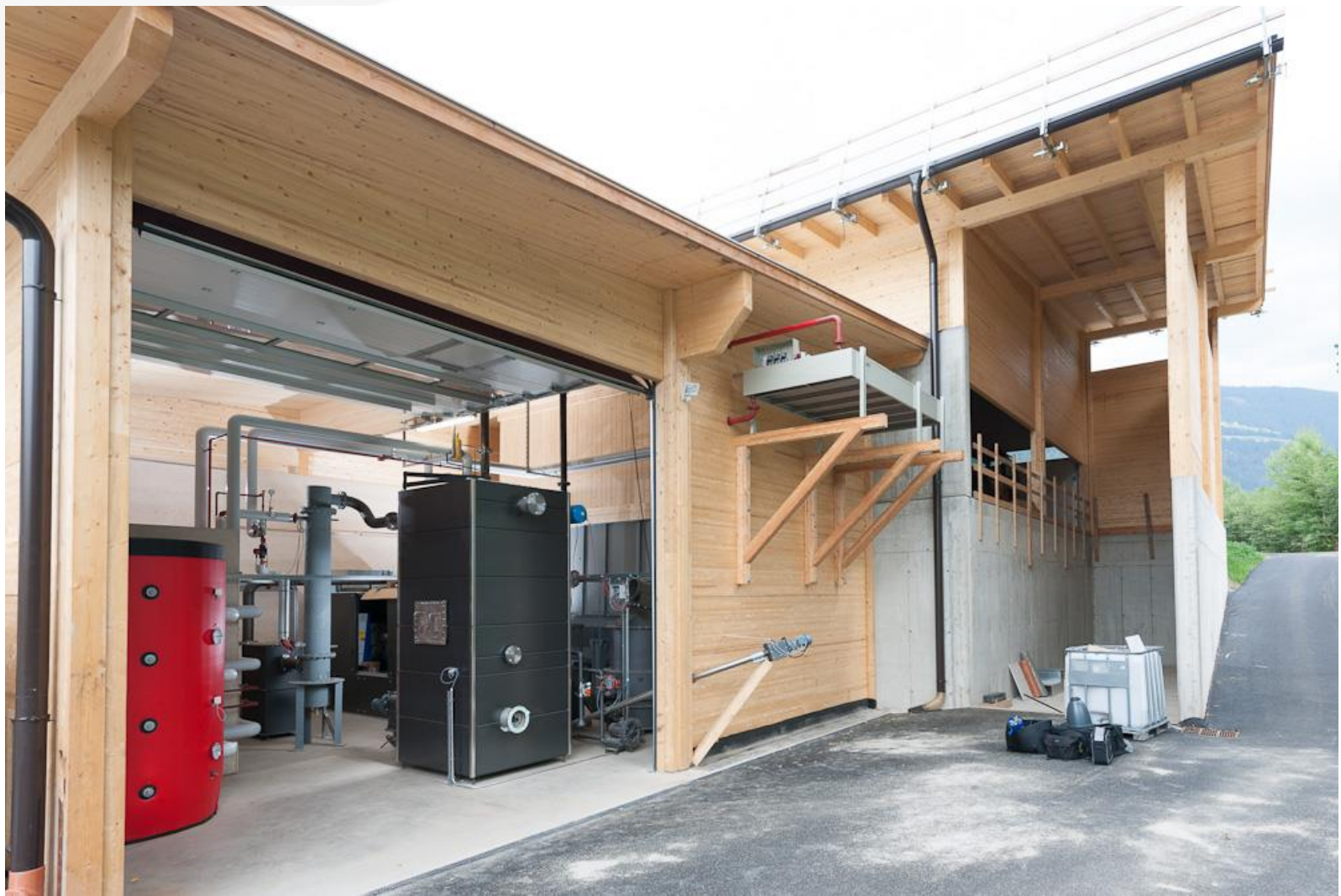
Anlage in Mühlbach/ Italien
