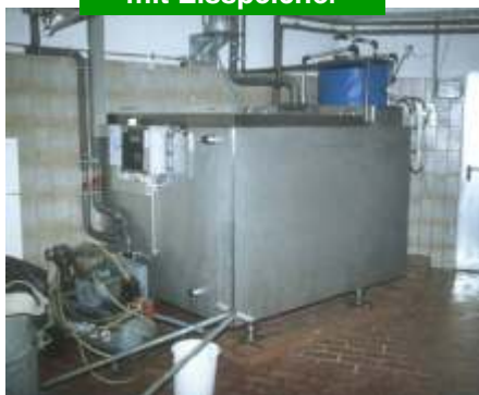
Eiswasserkühlung mit Eisspeicher
